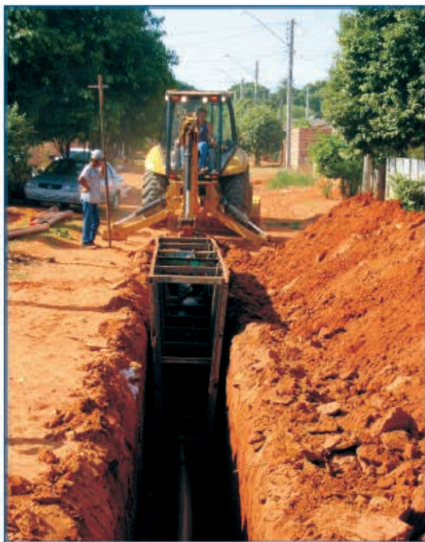
Guaiçara passará a ter 100% de seu território com esgoto coletado e tratado
