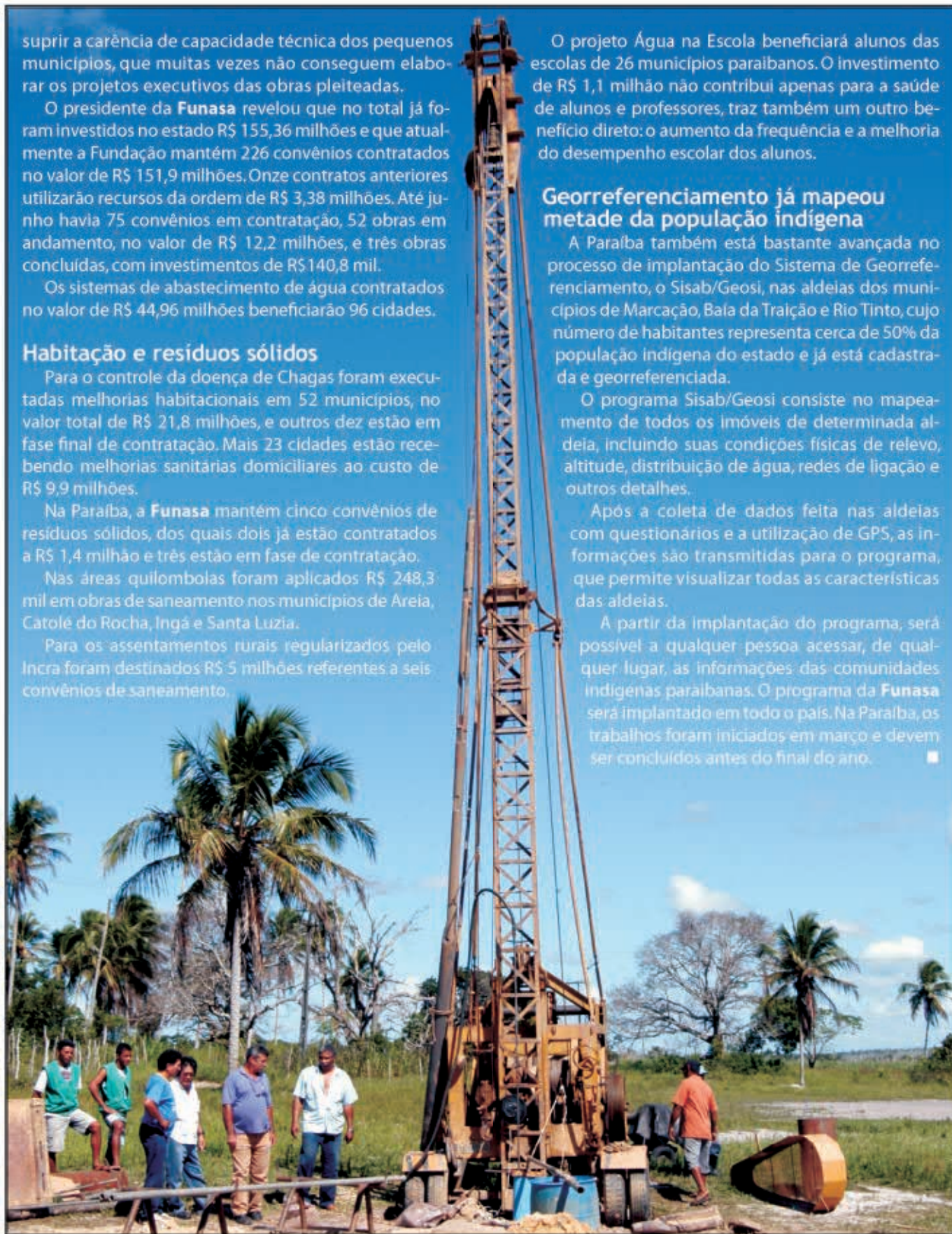
Perfuração de poço aumenta a oferta de água para o sistema de abastecimento da aldeia Ybykuará, no município de Marcação
